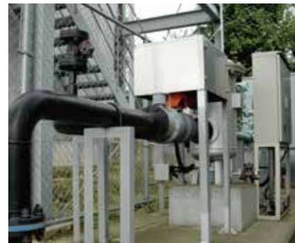
天然ガスの導入 (2006) Introduction of natural gas (2006)
