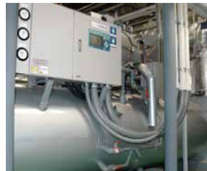
インバーター制御冷凍機導入 (2008) Introduction of higher-efficiency inverter controlled centrifugal chiller (2008)
